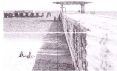
PONTE VELHA, no Poço da Draga, fechada após parte da estrutura desabar
